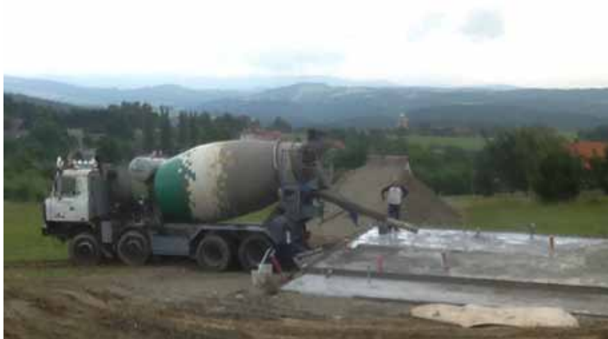
Nalévání betonu do základové desky. Beton byl dovezen z betonárky ve Velkých Hamrech
