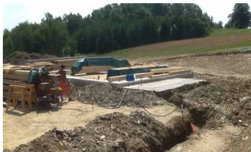
Zatímco se na stavbu svážel materiál na stěny, bylo třeba vykopat spáry pro potrubí
