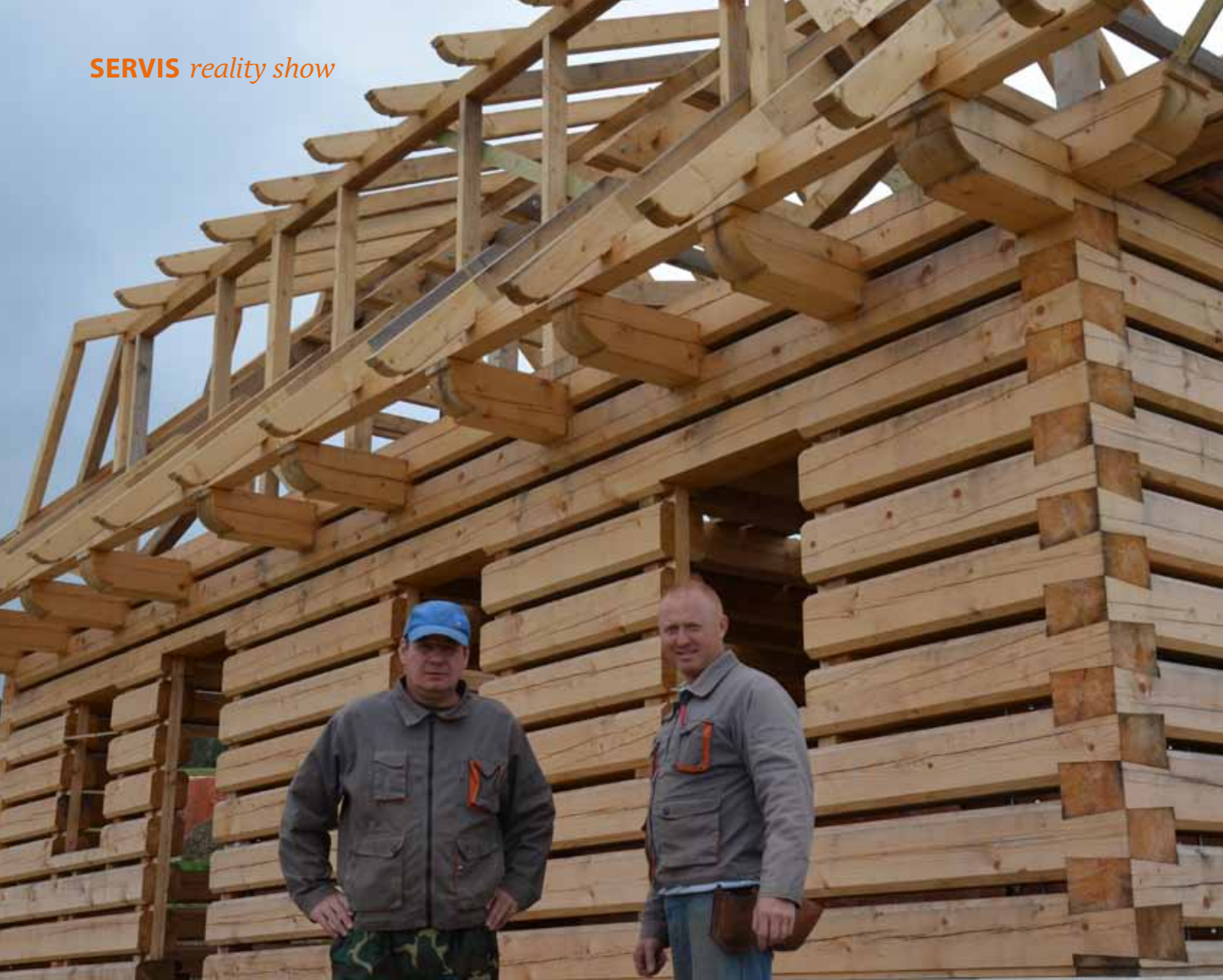
Dvojice tesařských mistrů, pánové Prokůpek a Matura před skoro dokončenou hrubou stavbou roubenky v Jílovém
